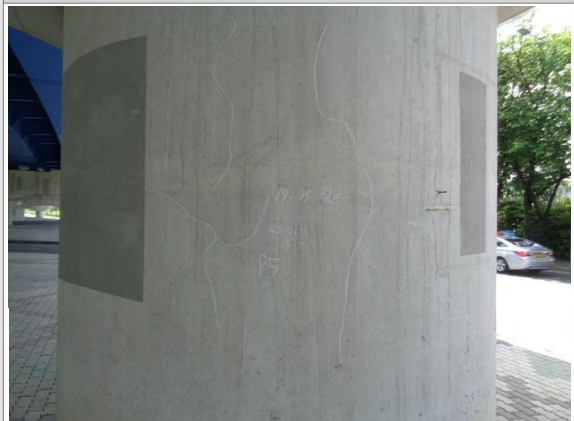
<P5> 기둥부 망상균열
